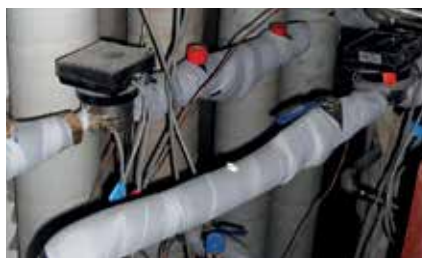
Балансировочные клапаны Danfoss ASV и термощетчики установлены в каждом техническом помещении для каждой группы из четырех квартир.
